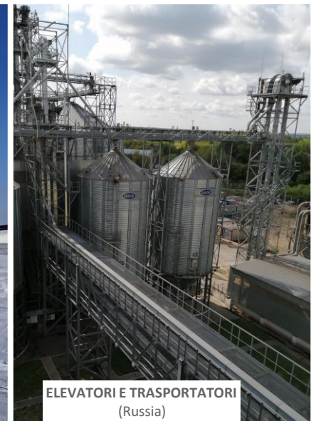
MECCANIZZAZIONE IMPIANTO A SILOS (Russia)
